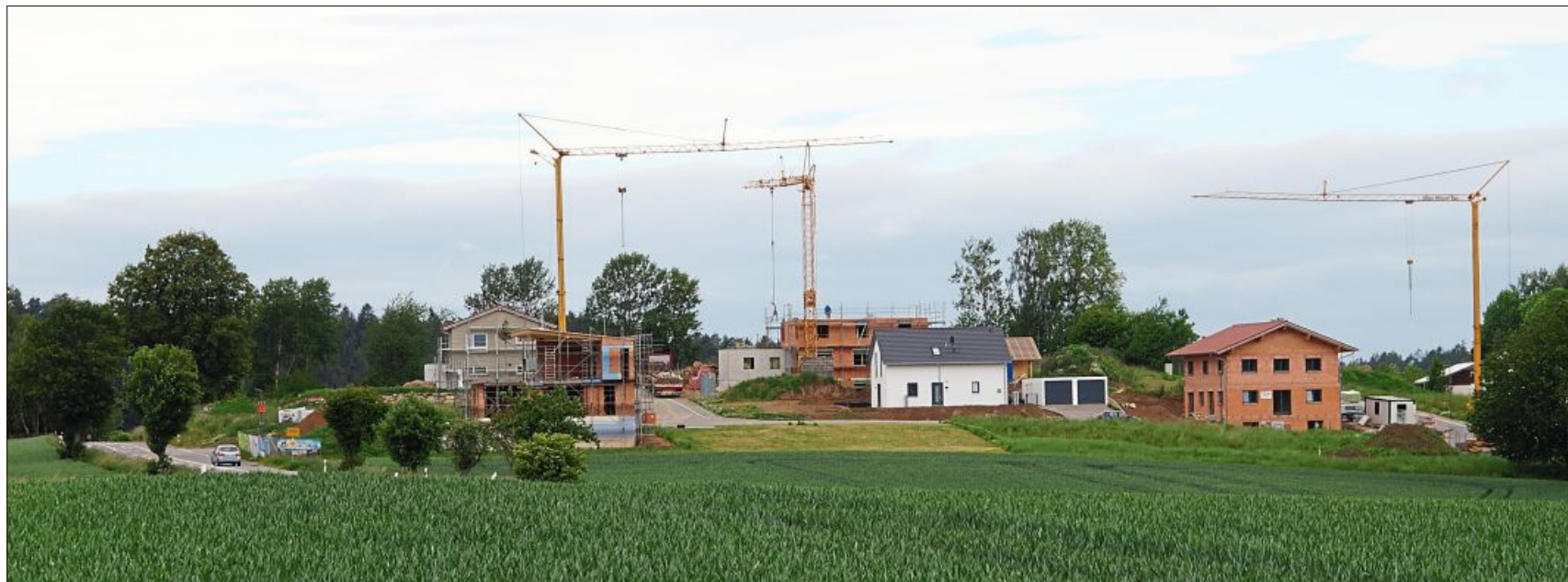
Blick auf das Baugebiet. Die Erschließungskosten lösten in der jüngsten Gemeinderatssitzung intensive Diskussionen aus.
