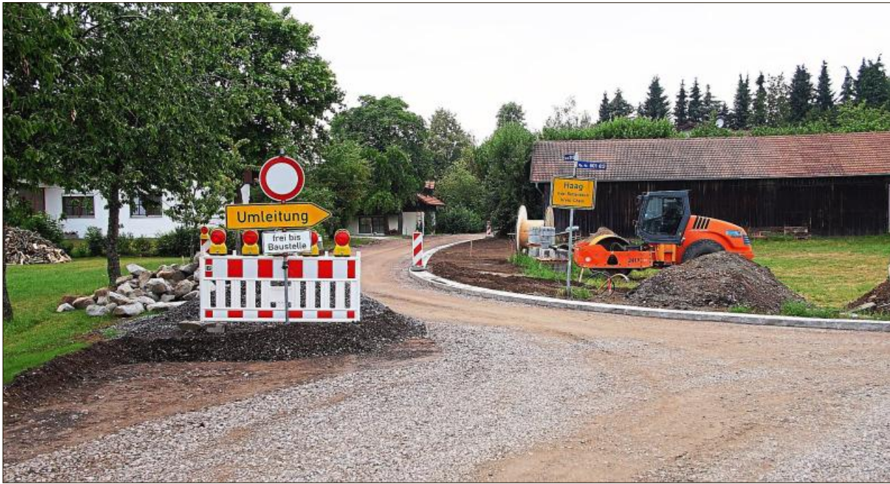
Die Durchfahrtsstraße wird demnächst asphaltiert. Dabei wurden auch Leerrohre für eine spätere Glasfaserversorgung eingebaut. Foto: Beiderbeck
